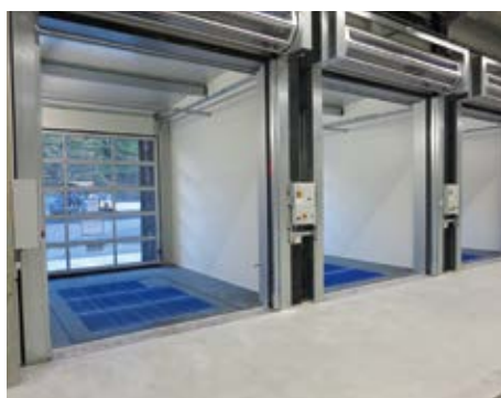
Integrados en túneles isotérmicos
