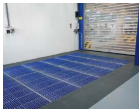
Compuertas de paso de materiales
