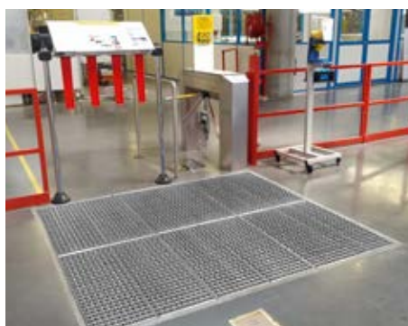
Limpieza de suelas y ruedas antes de zonas ESD
